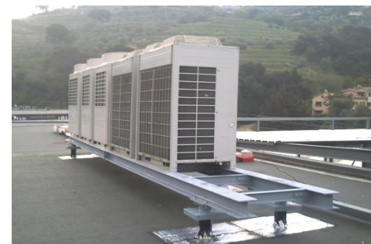
Support des groupes de climatisation
