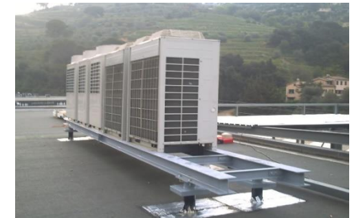
Support des groupes de climatisation
