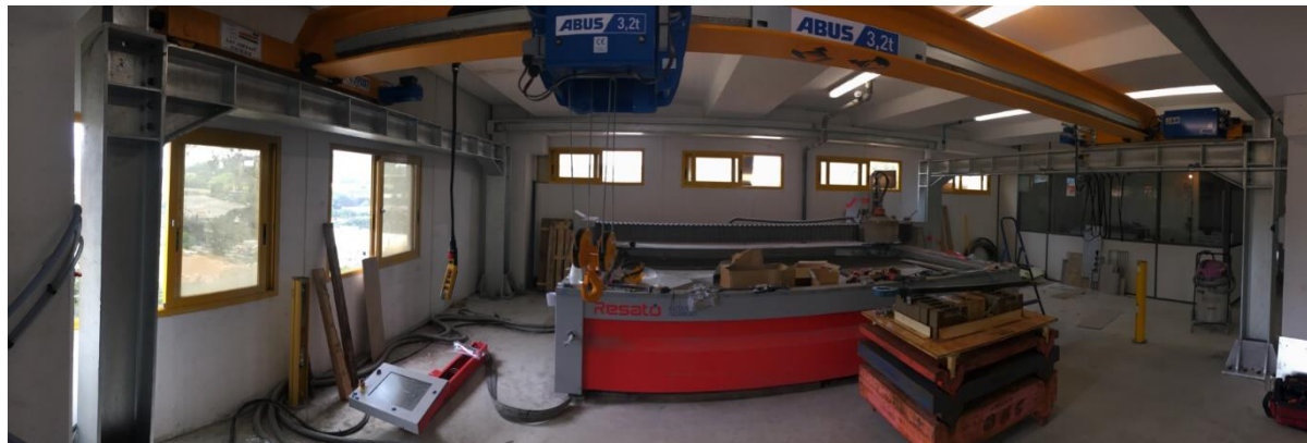
Pont roulant réalisé
