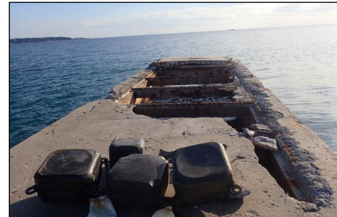
Dégradation de l'extrémité de l'épi n°4 (ICTP – novembre 2021)
