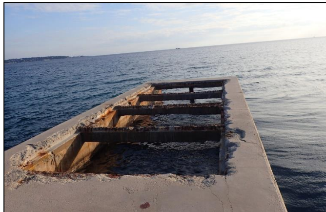
Dégradation de l'extrémité de l'épi n°2 (ICTP – novembre 2021)
