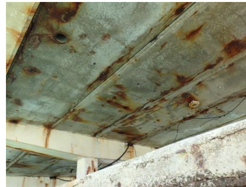
Ponton Carlton : dalles béton fissurées (01-2018)
