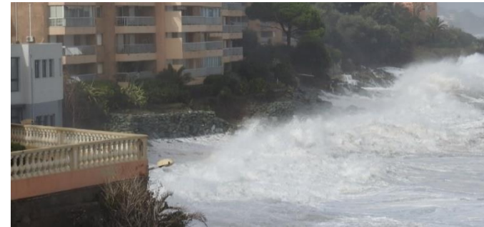
Brèche dans le mur de protection vue depuis le port de Toga Tempête Adrian 2018 - Copropriété I Minelli octobre 2018
