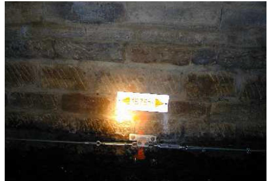
Ligne de vie installée en juillet 2002 - VNF
