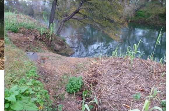
Berge en octobre 2015 (SISA) / Désordres en rive droite de la Siagne sur Mandelieu la Napoule vue de l'aval vers l'amont (ICTP, décembre 2015)
